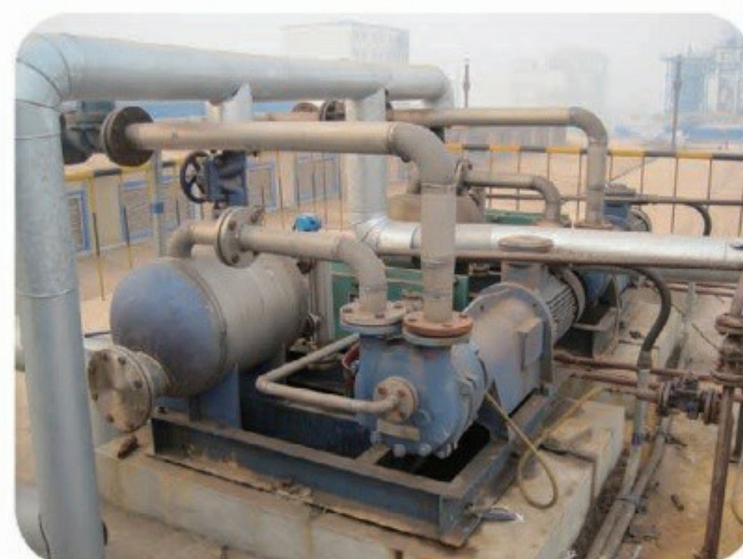
钛材氯气输送
