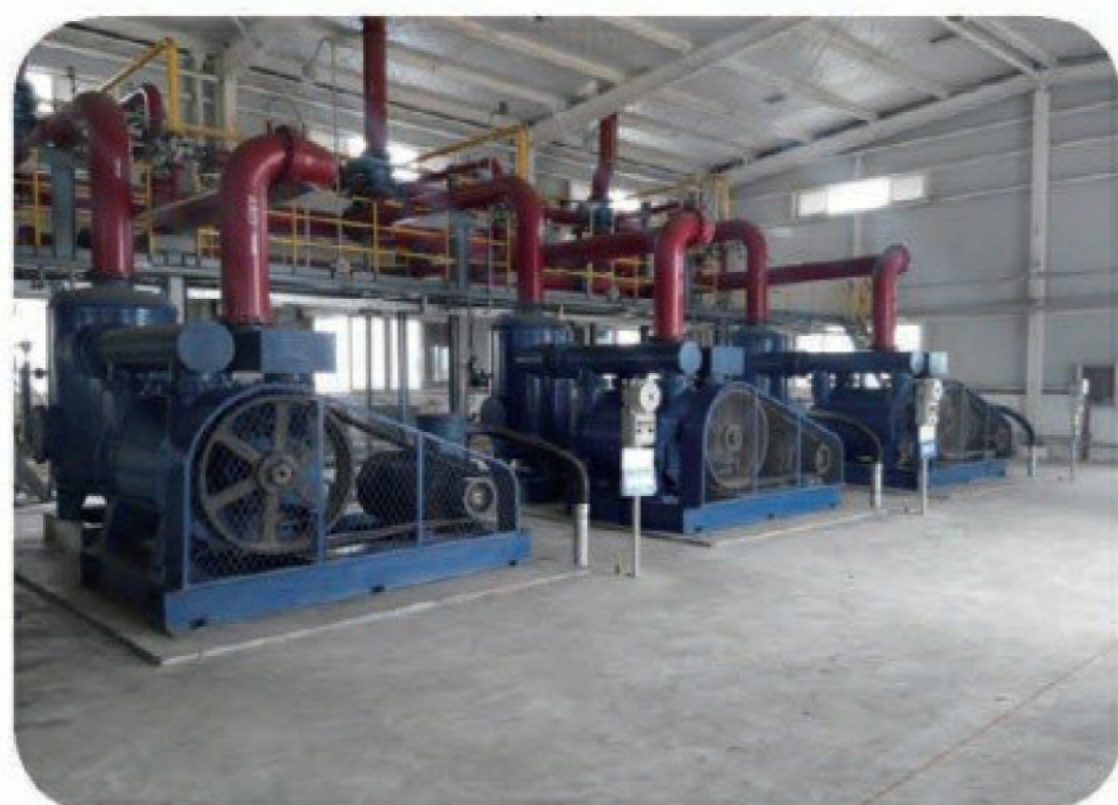
煤矿瓦斯抽放 Coal mine gas
